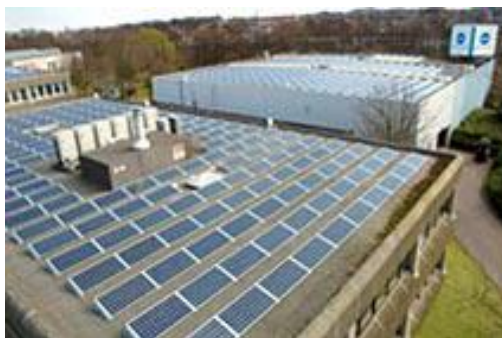
社屋に設置した太陽光発電設備(ベルギー)
